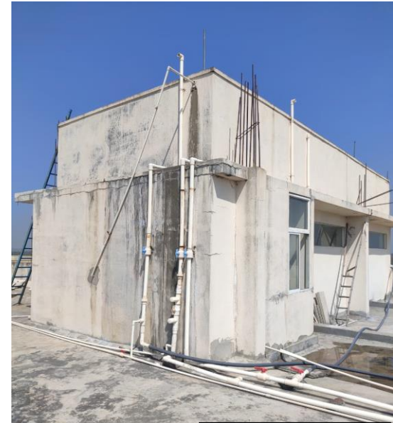
OVER HEAD WATERTANK1 AB BLOCK Longitude: 78°36'15.2"E Latitude : 17°20'59.4"N
