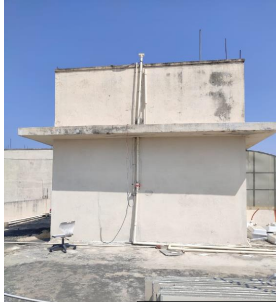
OVER HEAD WATERTANK AB BLOCK Longitude: 78°35'36.4"E Latitude : 17°21'15.6"N
